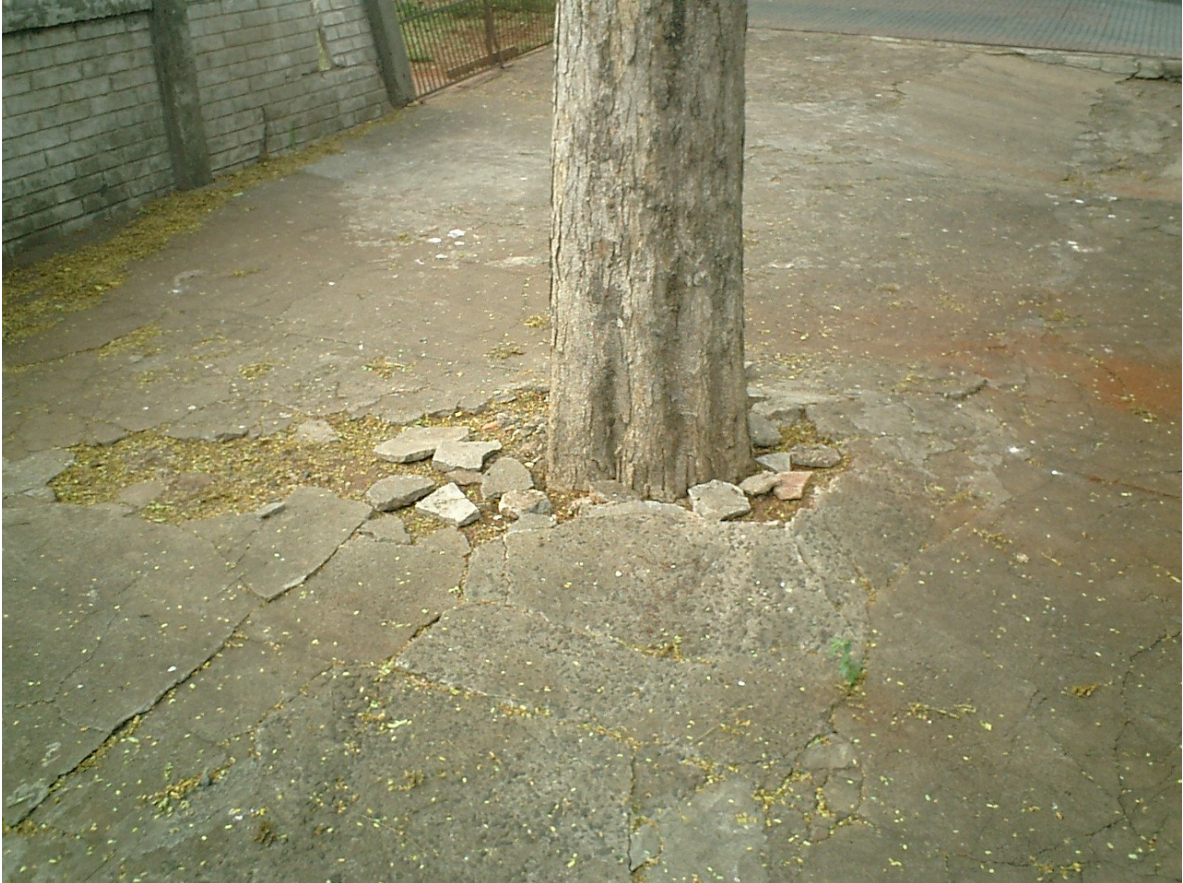
Foto 07 - Raiz de Caesalpineia peltophoroides destruindo calçada com pequena área livre.
